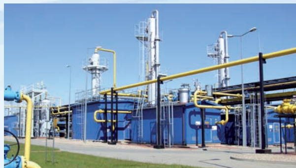
Instalacja osuszania gazu ziemnego
