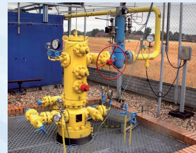
Głowica odwiertu K-18H
